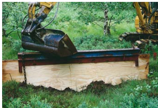
Fig. 75 Enfoncement du panneau à l'aide de la rétropelleuse et d'un profil métallique
