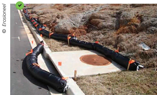
Type 4 : dérivation en place pour éviter que l'eau chargée ne rentre dans l'avaloir.
