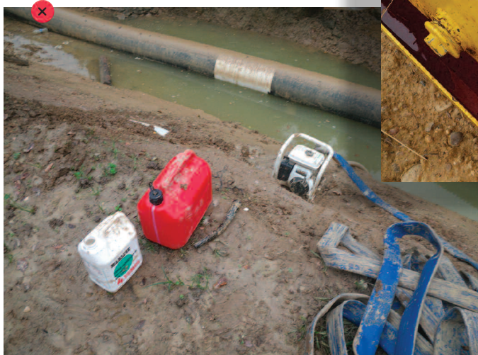
Stockage de bidons proches du milieu aquatique et groupe électrogène sans cuvette de rétention.
