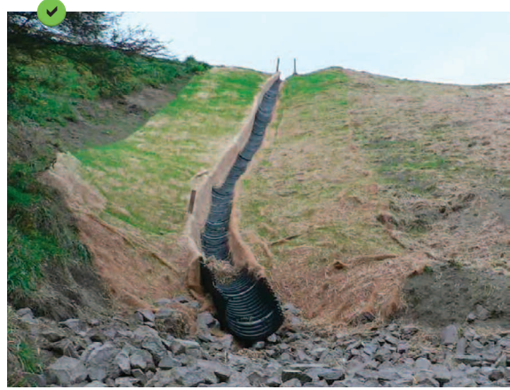
Demi-gaine HDPP sur une surface décapée mais ensemencée et paillée, avec équipement du point de rejet d'un dispositif anti-érosion.
