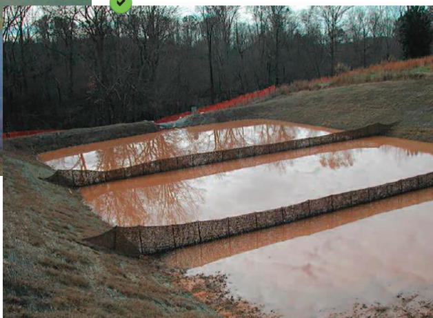
Bassin de décantation aux berges végétalisées et équipé de barrières perméables en toile coco.
