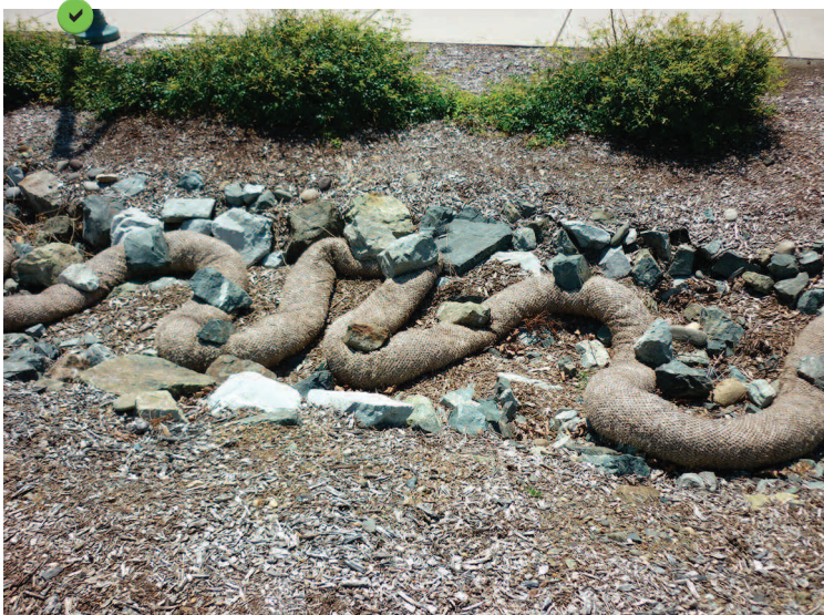
Boudin installé sur un fossé de collecte des écoulements superficiels, maintenu au sol à l'aide de blocs.
