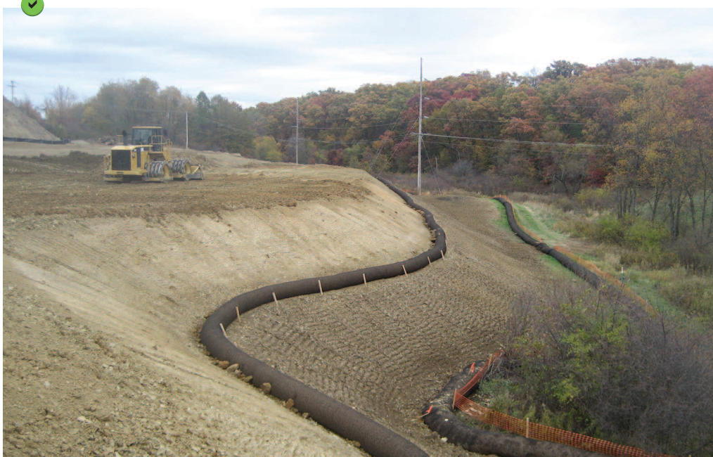
Approche multi-barrières appliquée à un talus découpé : lutte contre l'érosion par chenillage des sols, infiltration des écoulements superficiels à l'aide de boudins de rétention en série, maintien d'une zone tampon entre le chantier et le cours d'eau par mise en défens de la ripisylve
