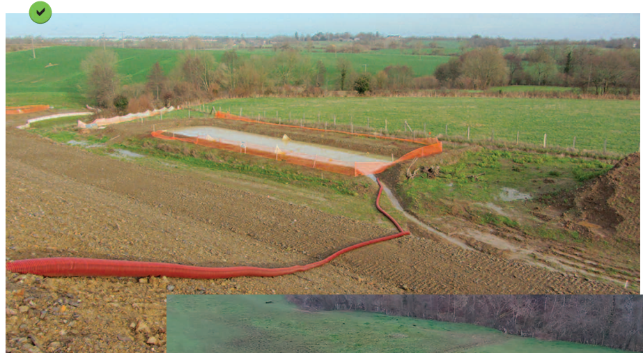
Drain de pente.
