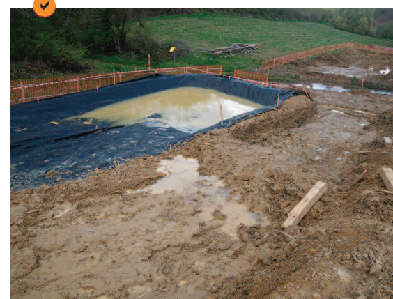
Piège à sédiments hors-sol : rapport longueur/largeur adapté, mais absence d'un dispositif de surverse.
