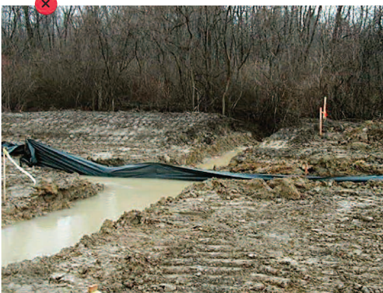
Ne pas installer de barrières de rétention en travers des cours d'eau.
