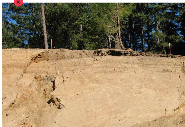
Glissement de terrain en cours.
