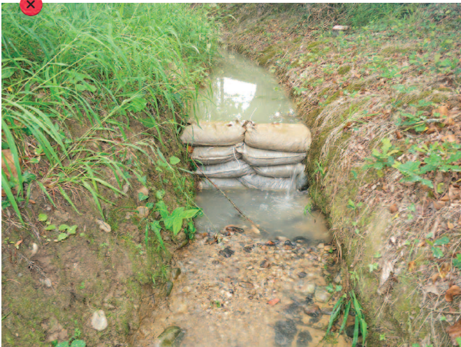
Seuil anti-érosion constitué de sacs de graviers placés au fond du fossé. Pour éviter un contournement sur les côtés, une surverse au centre aurait amélioré le dispositif.
