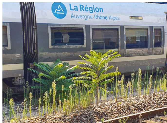
Figure 3-32 : Développement d'ailante glanduleux dans le ballast (SNCF Réseau)
