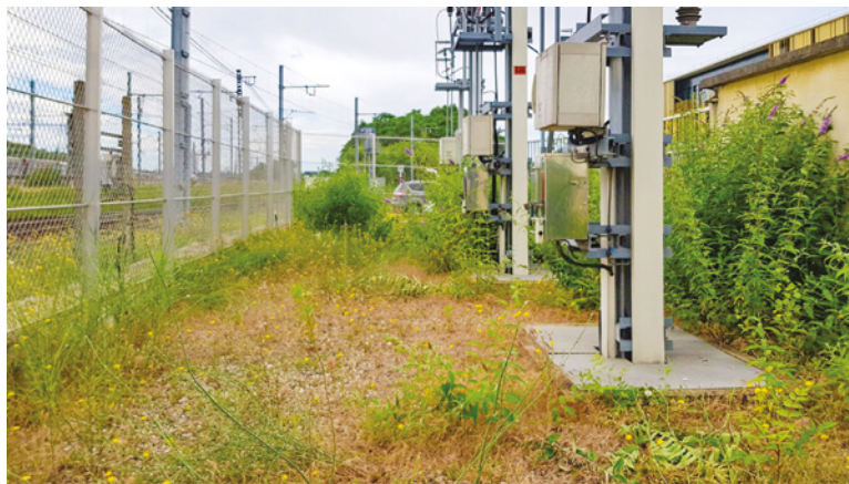
Figure 3-9 : Colonisation des sous-stations électriques par le buddléia et l'ailante (SNCF Réseau)
