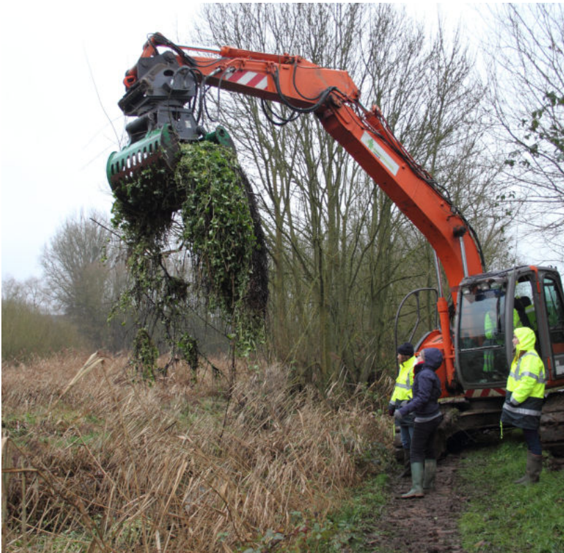
Fig 23. Une pelleuse placée sur la rive d'un ruisseau étroit est utilisée pour éliminer une population d'hydrocotyle fausse-renoncule. Photo : Jérémie Guyon
