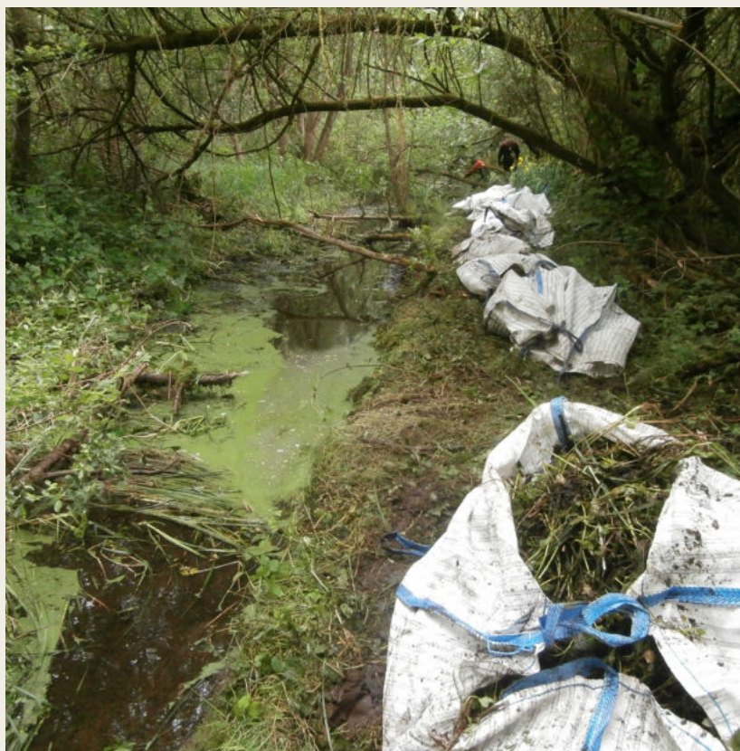
Fig. 126 La Les résidus de gestion ont été stockés temporairement dans des big-bags avant d'être exportés. Photo: Province du Brabant Wallon
