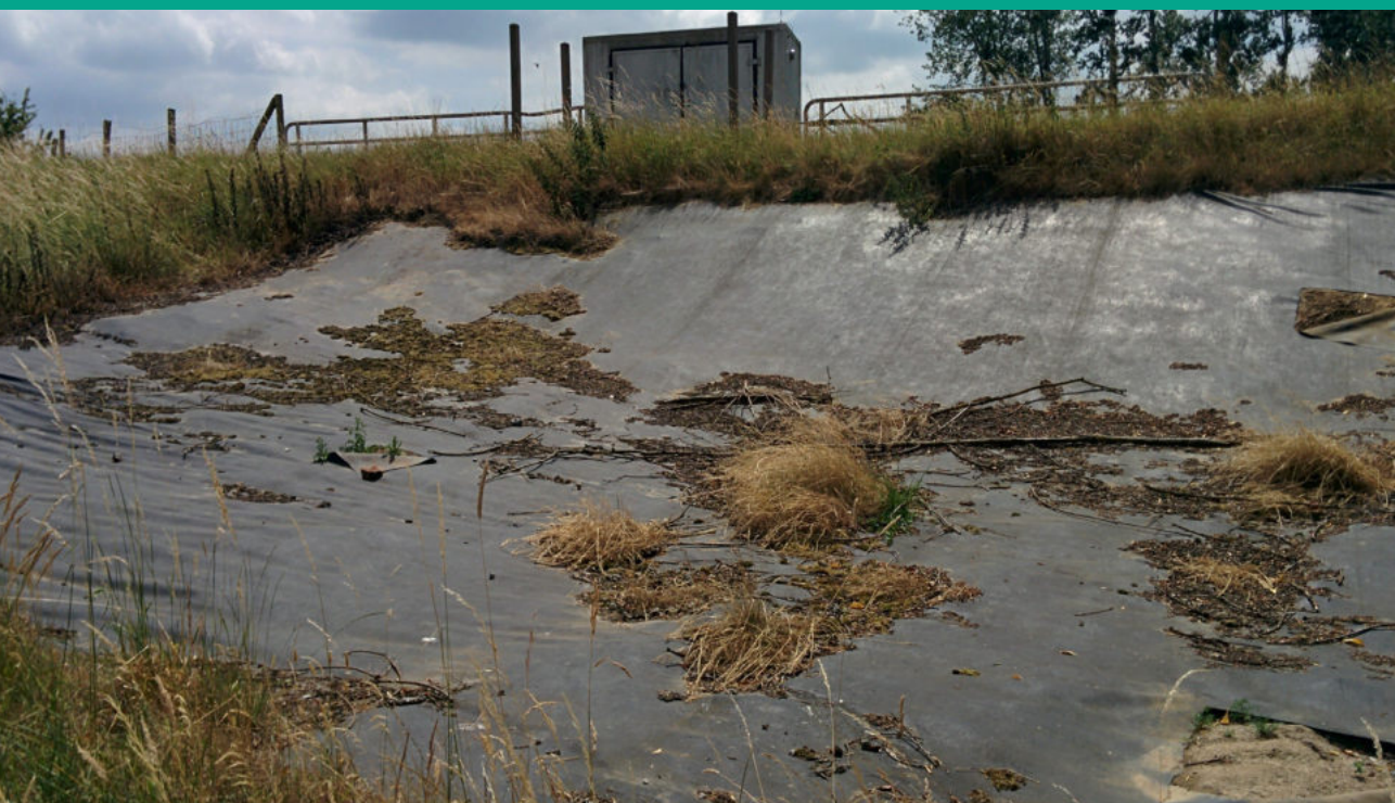
Fig 102. Il est nécessaire de vérifier l'absence de dommages à la couverture qui permettraient à la plante de pousser à travers le revêtement. Photo : Marijke Thoonen
