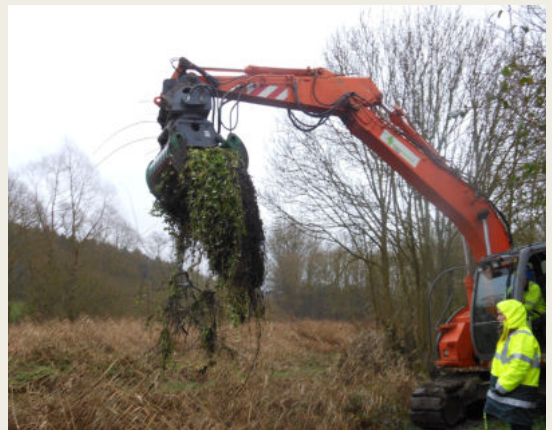
Fig 125. Afin d'éviter la dispersion de la population, un filet a été installé dans le cours d'eau. Photo: Province du Brabant Wallon
