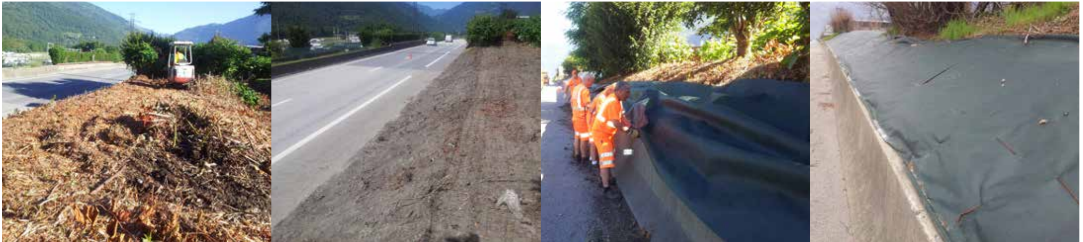
Fig 10. De la fauche préalable à l'installation de la bâche, sur un site envahi de renouées asiatiques / Laurent Bertrand, DIRCE CEI Aigueblanche
