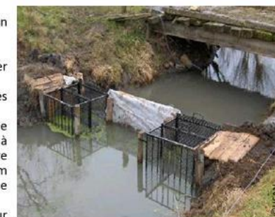
Barrage installé sur la rivière Vieille Lys
