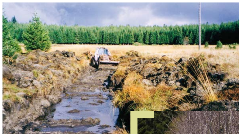
Des drainages pouvant être localement importants.
