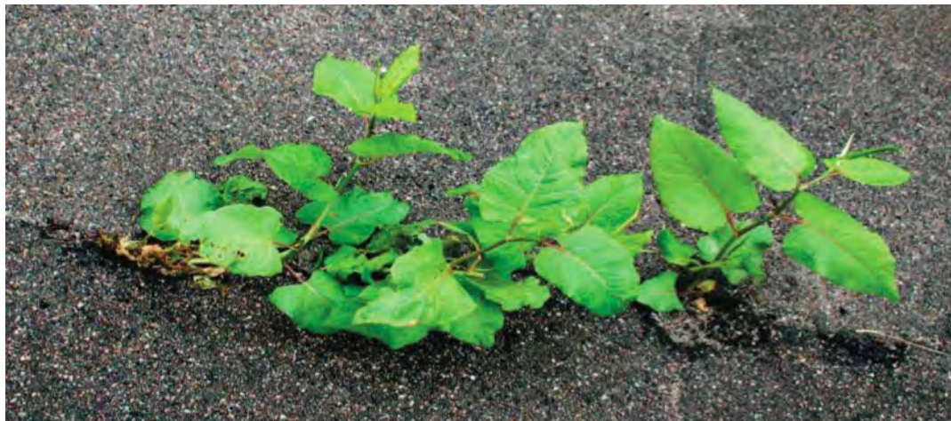
Figure 6 : Une Renouée passant à travers le bitume
