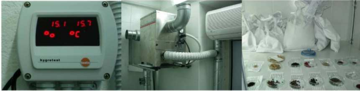
Figure 22 - Structure pour la déshydratation au BG-SAR: humidimètre avec valeur ambiante de l'humidité relative et température, déshumidificateur avec absorption chimique et matériel stocké. (photo: E. Mattana)
