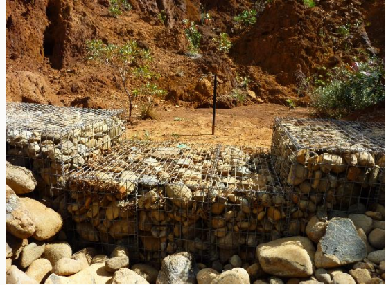
Seuil en gabions – La Coulée (Mont Dore)
