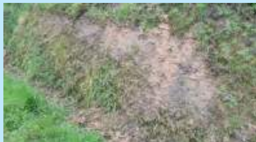
Broyage excessif des fossés. © Laëtitia Citeau
