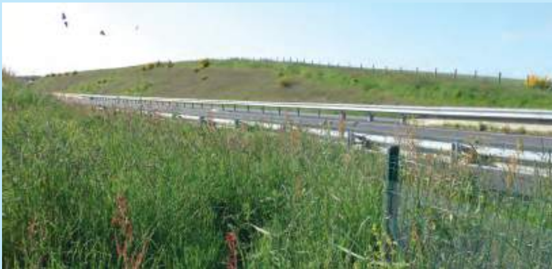
Talus peu végétalisé malgré la végétalisation à la conception. © Cerema
