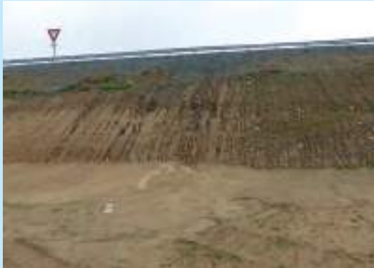
Érosion de talus avant végétalisation. © Cerema
