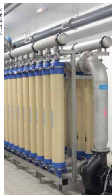
Une usine d'ultra-filtration (source des Eaux-Belles à Étrembières (Haute-Savoie).
