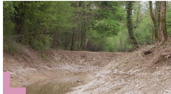
Sur la lône des Carronières, un curage important (1,60 m en moyenne) s'est avéré indispensable pour retrouver la nappe, localement très incisée.
