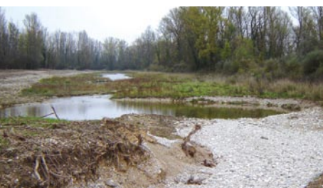
Sur la lône des Bateaux (Ain), deux chenaux ont été aménagés dans le bouchon aval : l'un pour faciliter les connections à la rivière, l'autre pour permettre une bonne évacuation de l'eau.
