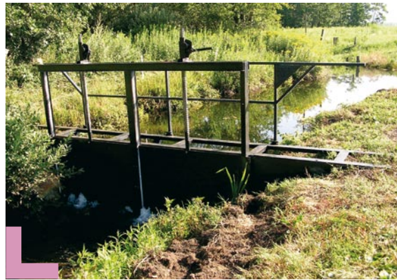
Vanne à grand gabarit (R.N. Marais de Lavours)
