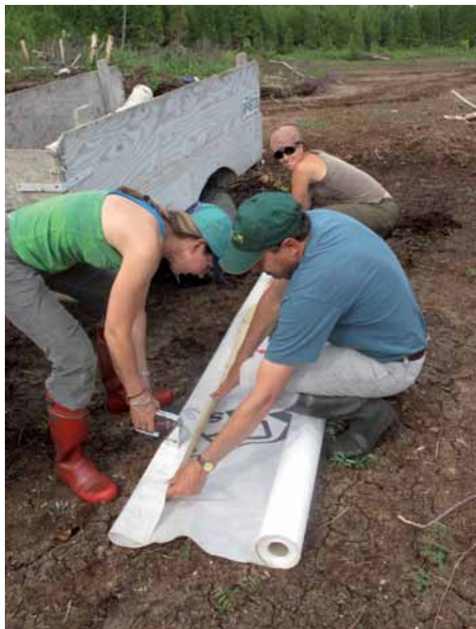
Figure 35. Installation d'un géotextile à la base d'un futur barrage à la tourbière de Bic - Saint-Fabien (Québec).
