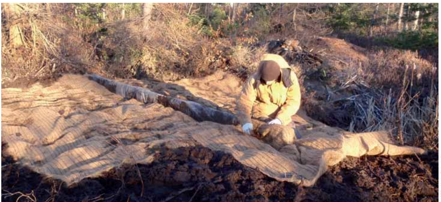
Figure 21. Installation d'un filet de stabilisation à la tourbière de la Grande plée Bleue (Québec).
