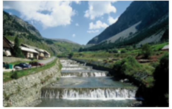
Barrages de correction torrentielle sur le cours de la Cervereyette dans le village de Cervières (Hautes-Alpes)
