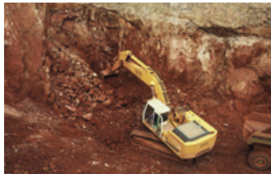
Exploitation de la bauxite dans la mine à ciel ouvert de Villeveyrac (Hérault)
