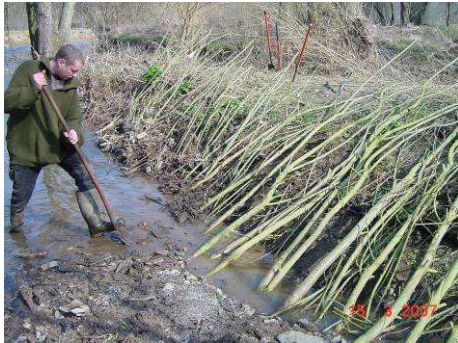
Photo 49. Perches mise en contact avec l'eau.
