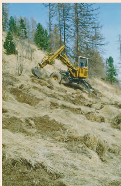
Sur pente forte (jusqu'à 60 %), l'ouverture de potets se fait au godet de 50 litres monté sur pelle araignée.
